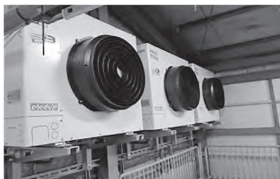
図4 閉鎖型豚舎に設置した農業用ヒートポンプ式エアコン
