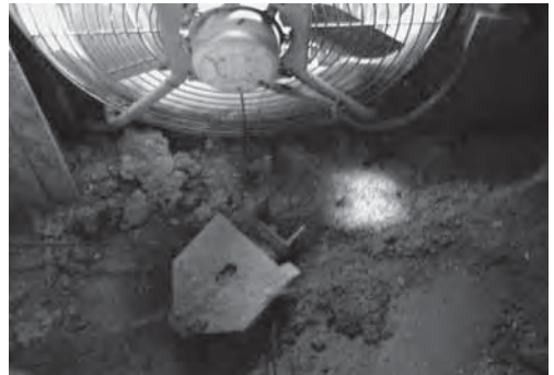
排気ファンの舎内側。(写真)
