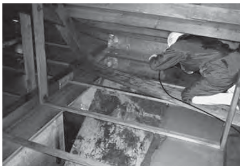
屋根裏の水洗。(写真)
